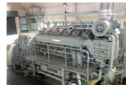
例：自家発電機の整備
