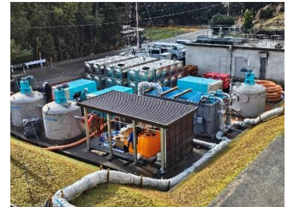
図-2 仮設置されたMST-2300S×3基
