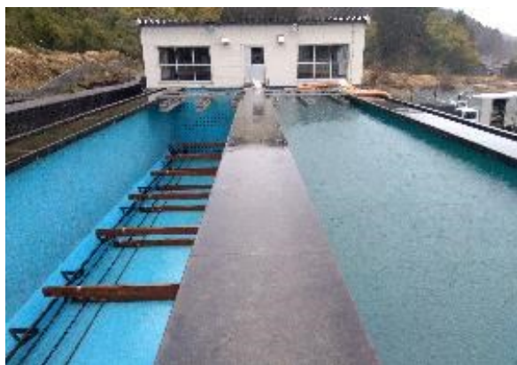
浄水場の被害（珠洲市）
