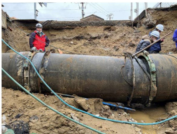
送水管の被害（七尾市）
