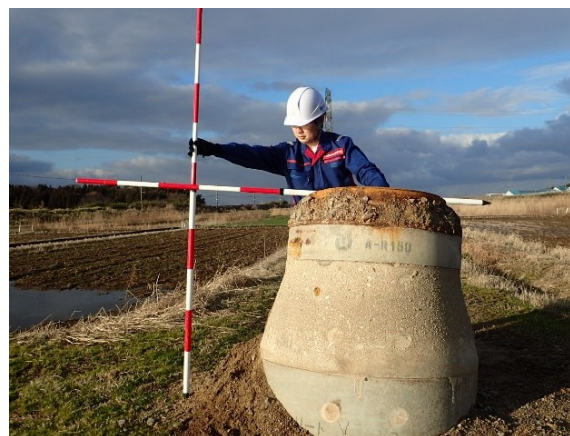
マンホール浮上現場（中能登町）
