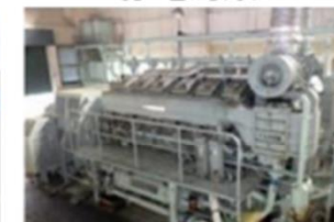
例：自家発電機の整備
