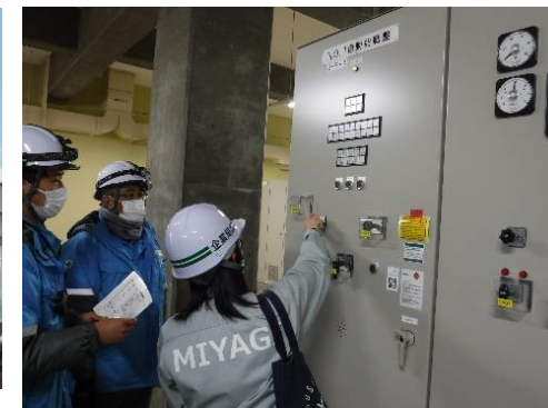
非常用発電機点検教育
