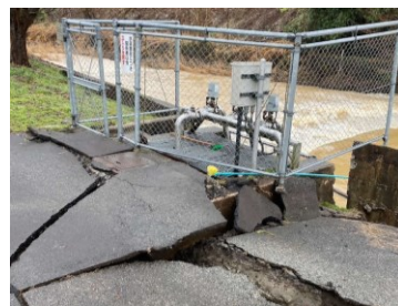
浄水場取水口の損傷
