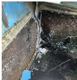
浄水場沈澱池の躯体ひび割れ
