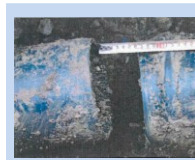
配水管の被災
