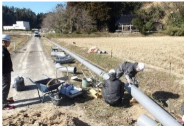
下水圧送管の被災（珠洲市）
