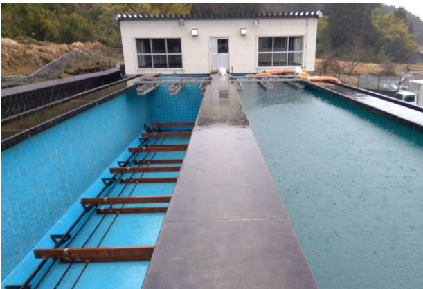
浄水施設の被災（珠洲市）
