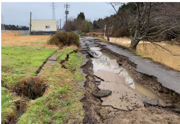
導水管の被災（珠洲市）
