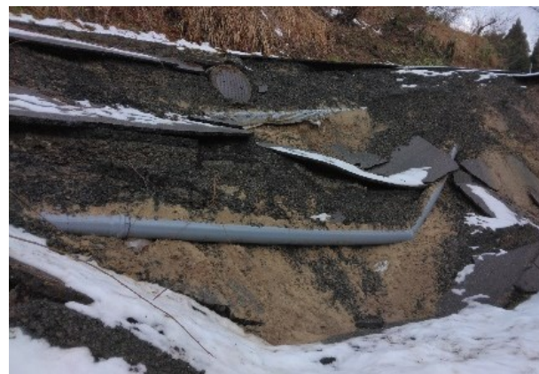
送水管の被災（輪島市）
