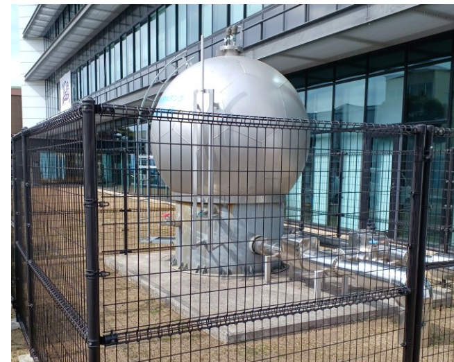
上下水道局に設置した 貯水機能付給水管
