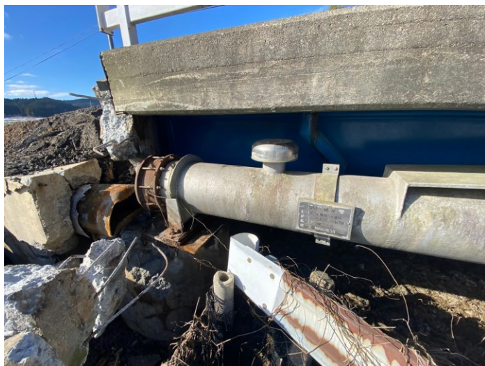
送水管450mm破損(珠洲市)
