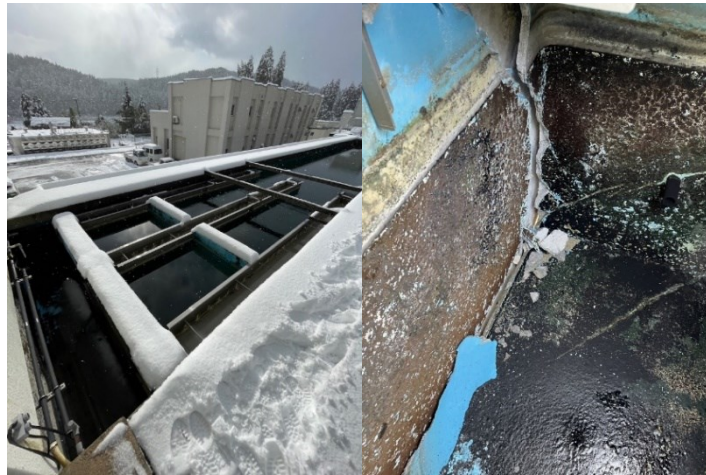
宝立浄水場・沈澱池クラック(珠洲市)
