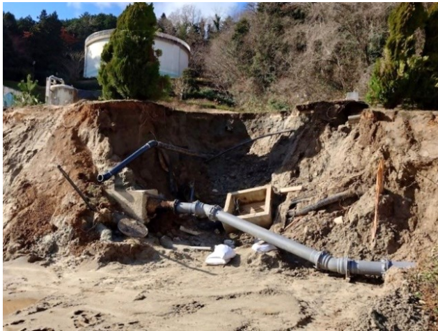
岩屋浄水場・場内配管損傷(七尾市)
