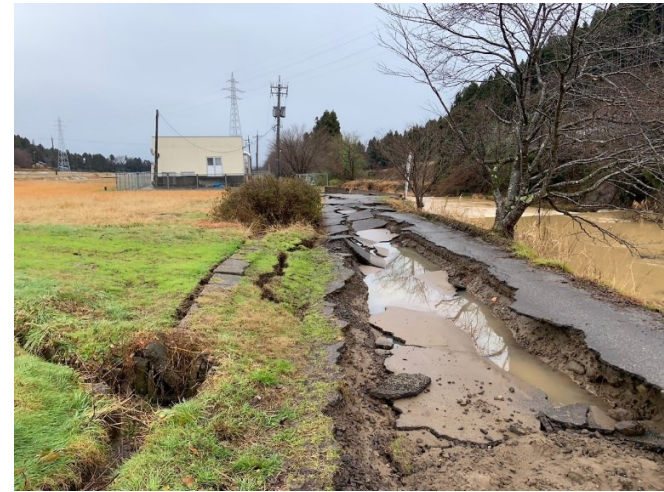
宝立浄水場・導水ルート(珠洲市)
