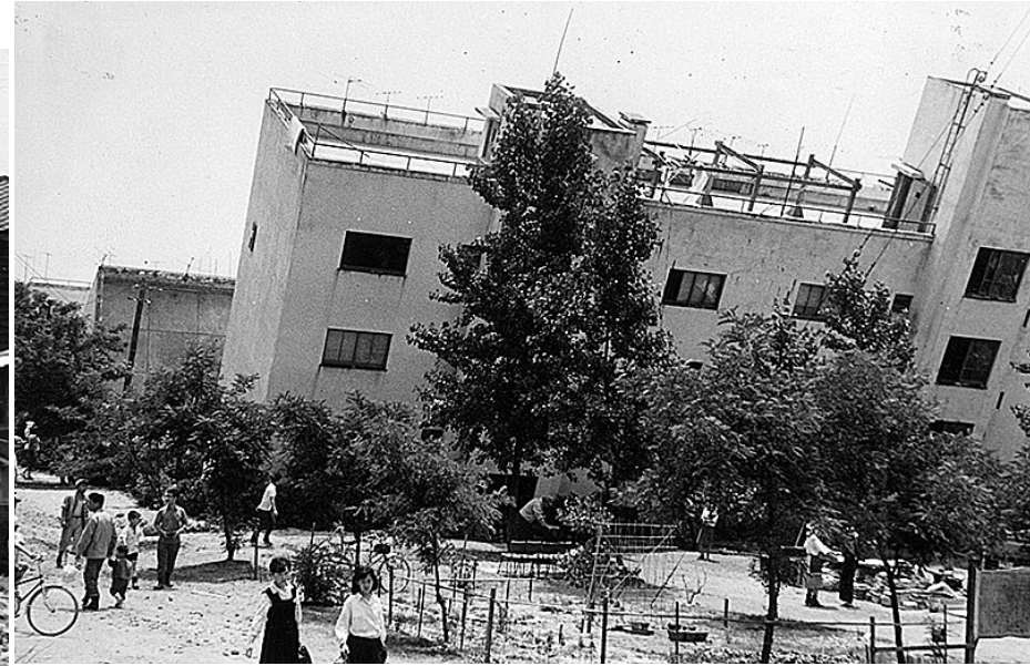
液状化現象により河畔の県営川 岸町アパートが大きく傾斜
