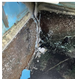
浄水場沈澱池の躯体ひび割れ
