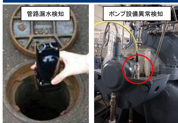
振動センサーによる状態監視
