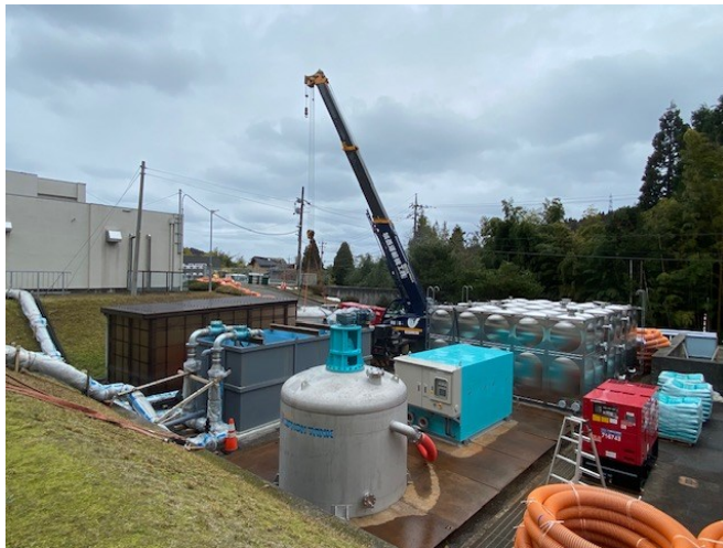
宝立浄水場可搬式浄水施設・設備
