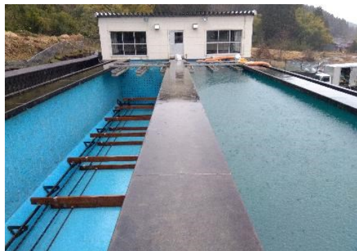
水道水をつくる浄水場の被災 (珠洲市宝立浄水場の沈澱池)
