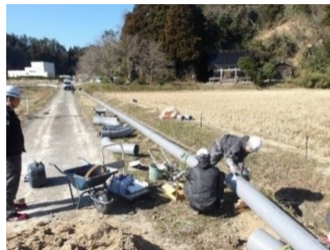
区域の下水を集約し処理場へ送る圧送管の被災 (珠洲市熊谷ポンプ場からの圧送管)
