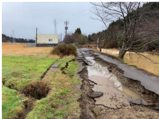
水源から浄水場へ送る導水管の被災 (珠洲市宝立浄水場の導水管)
