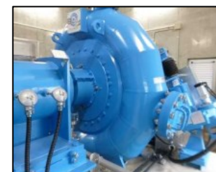
水道の再エネ機器 (小水力発電)
