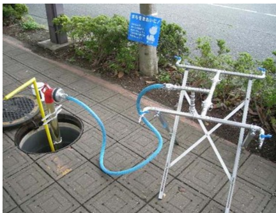
消火栓からの仮設給水栓
