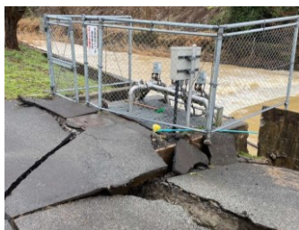
浄水場取水口の損傷
