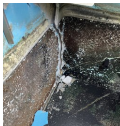
浄水場沈澱池の躯体ひび割れ
