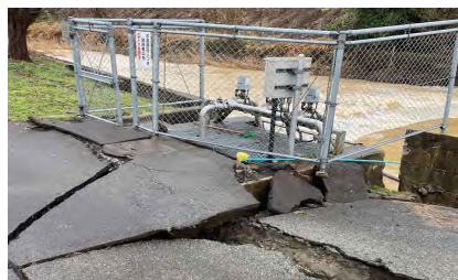
浄水場取水口の損傷
