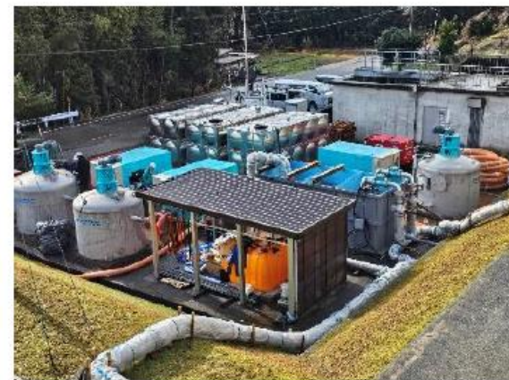
図-2 仮設置されたMST-2300S×3基
