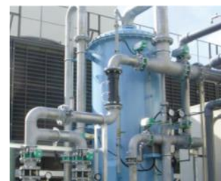
急速ろ過器 除鉄除マンガンろ過器
