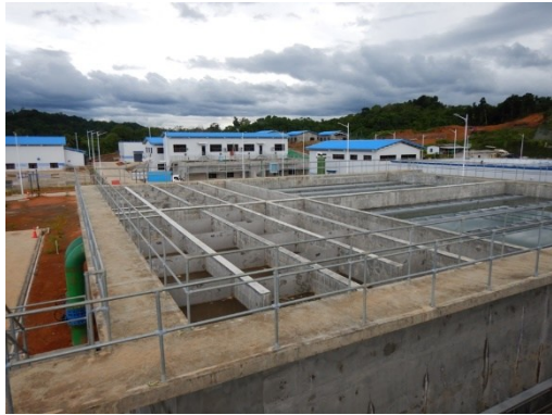
凝集沈殿池①
