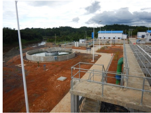
汚泥の沈殿池
