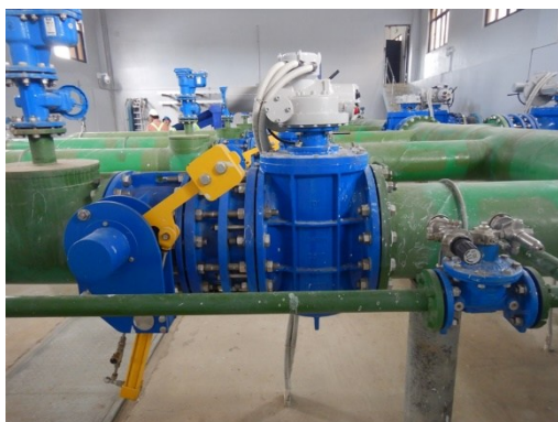
取水ポンプの流量計とバルブ
