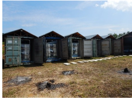
RO 膜機材及び UF 膜機材
