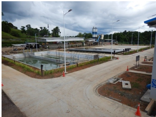
汚泥ラグーンと袋式スラッジ貯留
