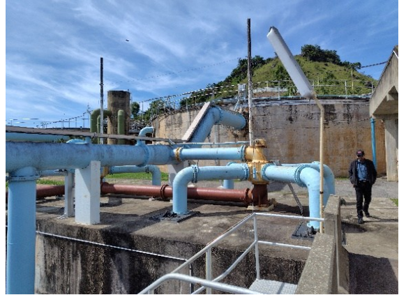
凝集池からろ過槽への送水管
