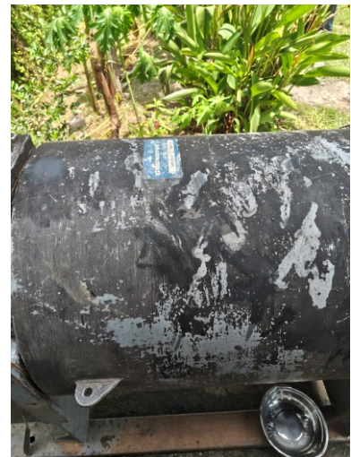
故障したポンプ
