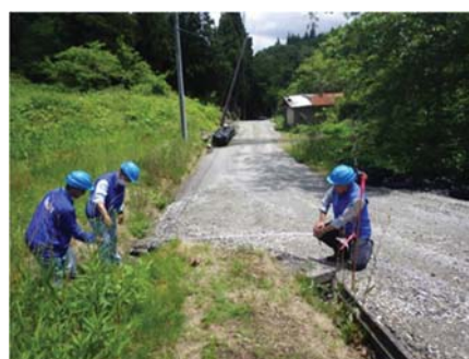
U字溝のずれ2m(5月29日撮影)
