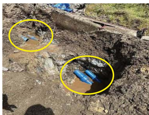
破損した継手の状況
