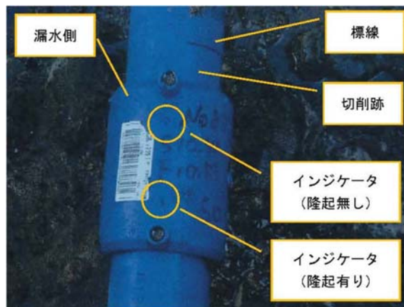
漏水したEFソケット50mm (修繕工事写真より)
