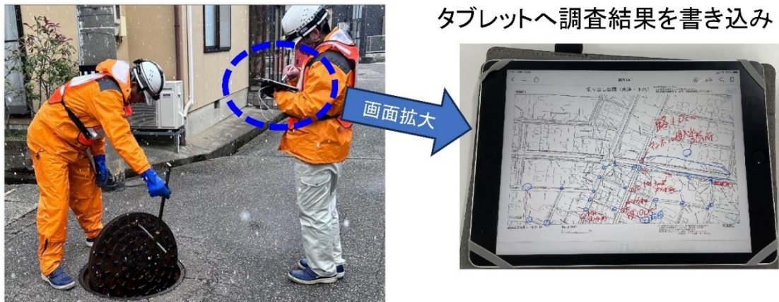
図-1 下水道台帳（電子）とタブレット端末等の活用による応急復旧調査の効率化
