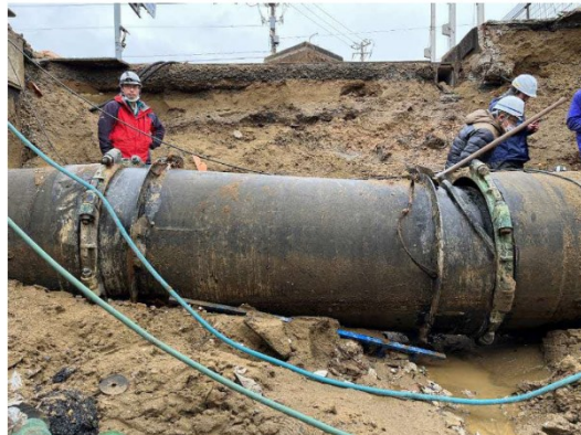
送水管の被害（七尾市）
