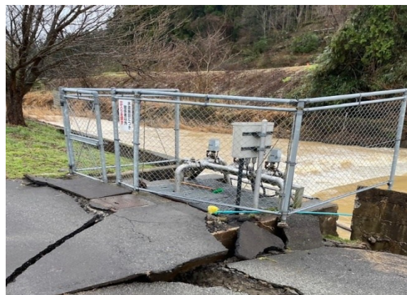
宝立浄水場・鶴飼川取水口(珠州市)
