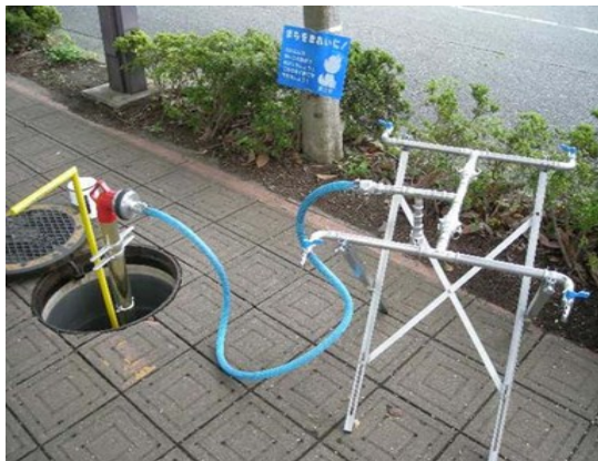
消火栓からの仮設給水栓
