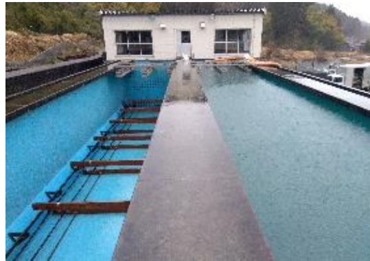
浄水場の被害（珠州市）
