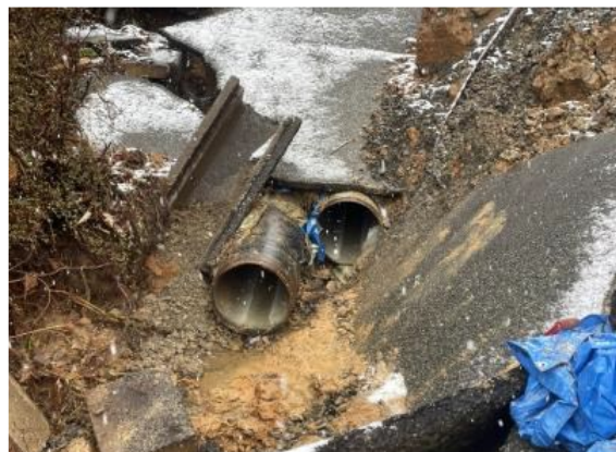
NS形ダクタイル鋳鉄管(輪島市)
