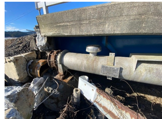
送水管450mm破損(珠州市)
