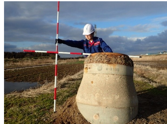
マンホール浮上現場（中能登町）
