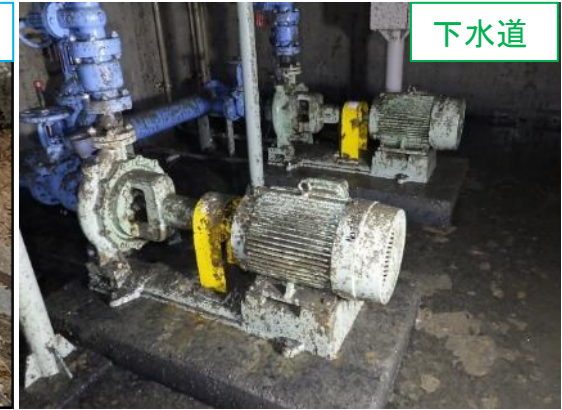
終末処理場の浸水被害 (福岡県新宮町)
