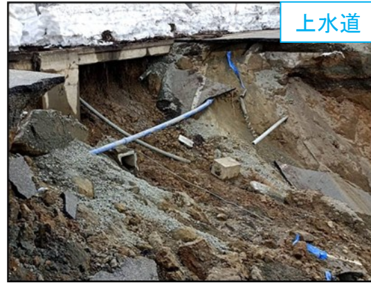
融雪災害による管体の破断 (新潟県柏崎市)
