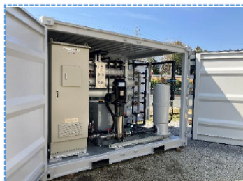
写真① コンテナ式分散型ユニット
