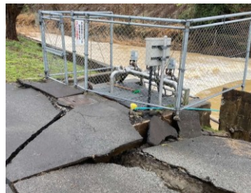
浄水場取水口の損傷
