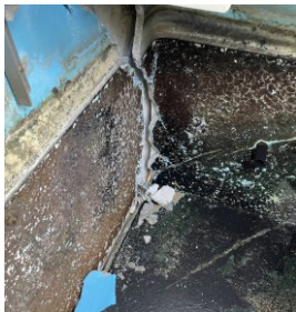
浄水場沈澱池の躯体ひび割れ
