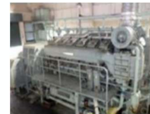
自家用発電機の整備
