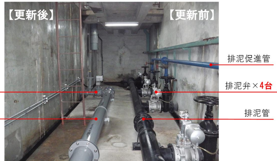
写真 レシプロ式汚泥掻寄機の採用による更新前後の状況(排泥管廊)
