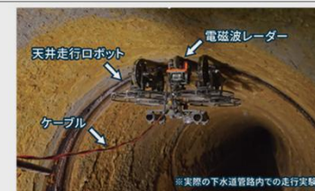
天井走行ロボットの実証（熊本市）
