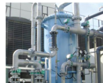
急速ろ過器 除鉄除マンガンろ過器
