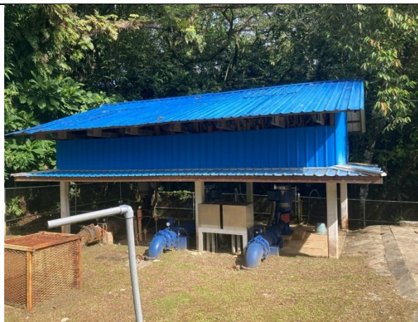
取水ポンプ施設外観
