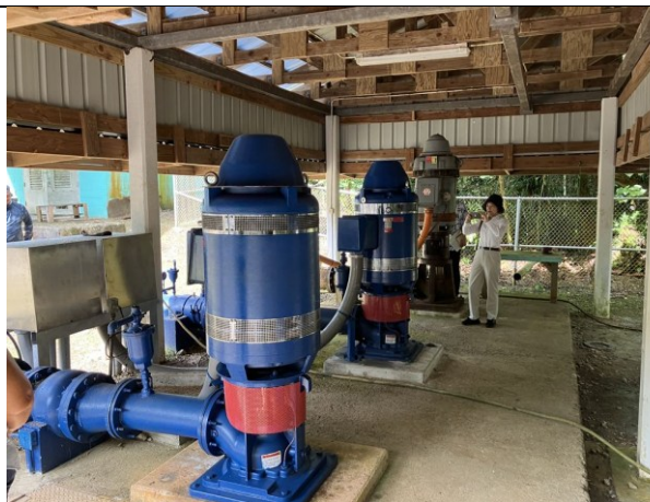
取水ポンプ設備
