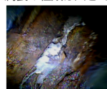
【Aランク】 鉄部腐食
