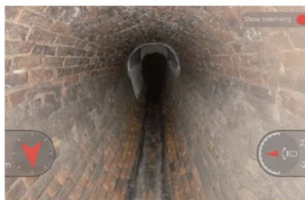
管路内調査の画像 ※動画のスクリーンショット
