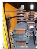
写真 2. 36kV 用 EVT (23 年経過、未点検)
