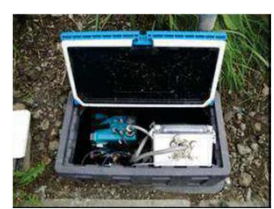
量水器ボックス内の設置状況
