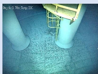
水を抜かないIROVなら高所の目視も足場不要！
