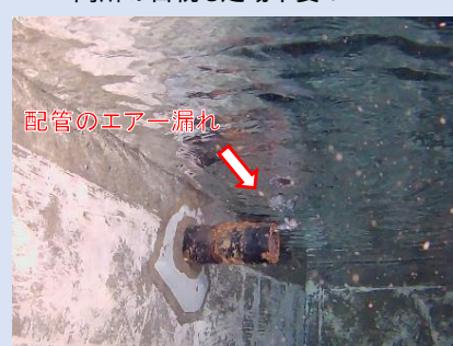
水を抜いた状態では見えない劣化もROVなら確認可能！
