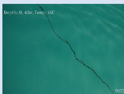
壁面ひび割れ状況
