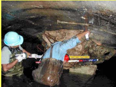
約4.5mにわたって岩盤が崩れた現場 = 広島県公営企業部提供
