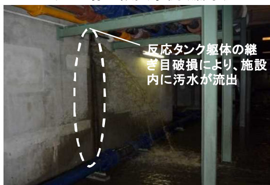
処理場の被災事例（漏水）
