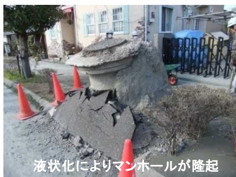
管路の被災事例
