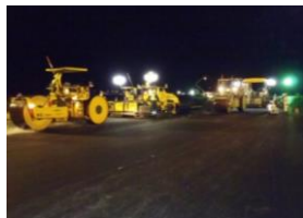
（老朽化した滑走路舗装の改良）
