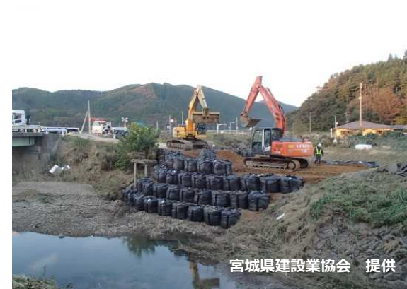
宮城県建設業協会会員による河川堤防緊急応急 (台風19号 宮城県津山町)
