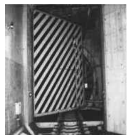
防水扉(トンネル内)
