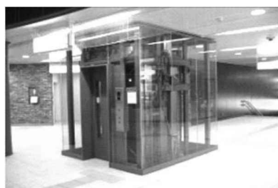
エレベーター
