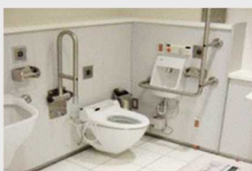
車椅子使用者用トイレの整備
