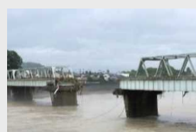
西瀬橋の被災状況
