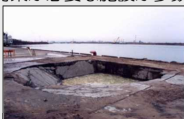
陥没した港湾施設のエプロン
