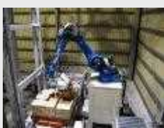
ピッキングロボット
