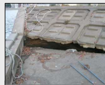
クラックが生じた河川護岸
