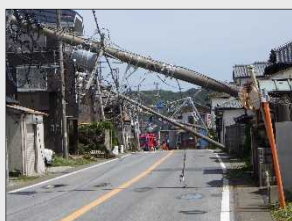
＜令和元年房総半島台風による被害＞
