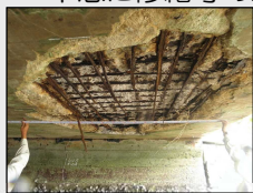
内部の鉄筋が露出した橋梁
