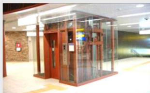
段差の解消（エレベーター）
