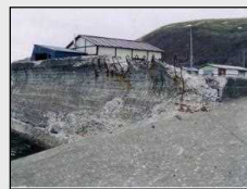
老朽化した海岸堤防
