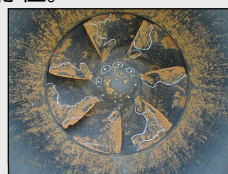
腐食した排水ポンプ場の羽根車
