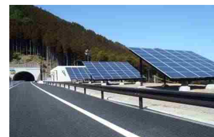
<道路における太陽光発電の活用>
