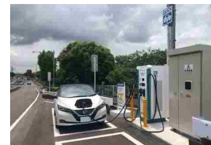
< EV充電器の公道設置（横浜市） >
