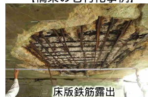
床版鉄筋露出
