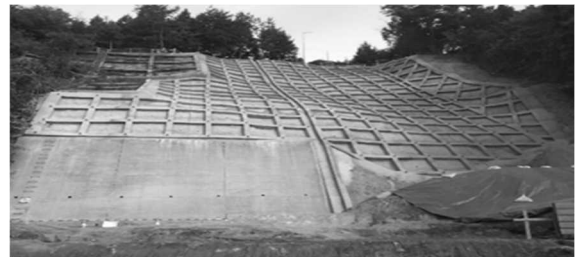
コンクリート枠による斜面の補強
