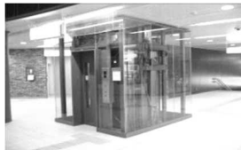
エレベーター
