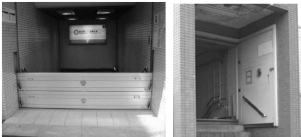
止水板・防水扉の整備
