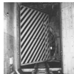
防水扉(トンネル内)
