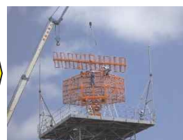
(老朽化した空港監視レーダーの更新)
