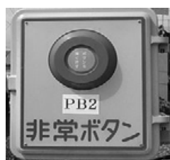
非常押しボタン
