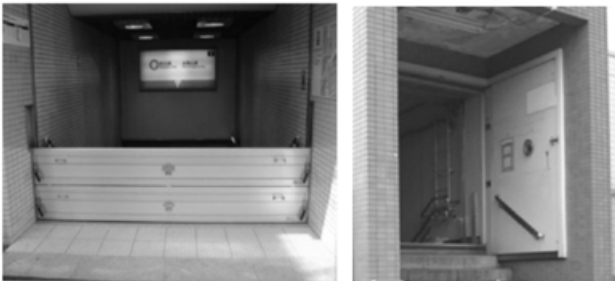
止水板・防水扉の整備
