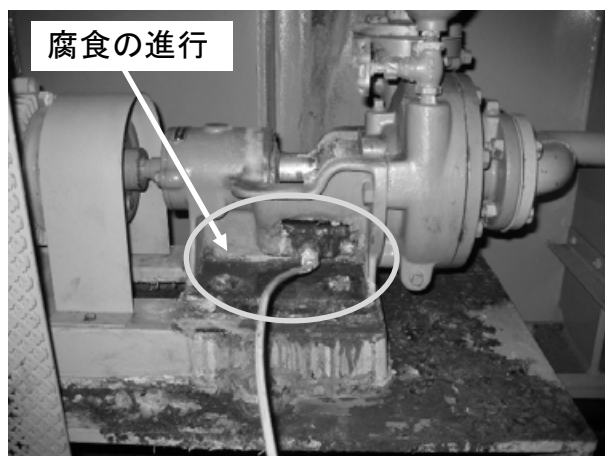
排水設備の劣化
