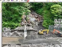
<国道274号の被災状況>
