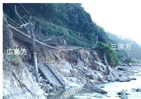
鉄道隣接斜面の崩壊
