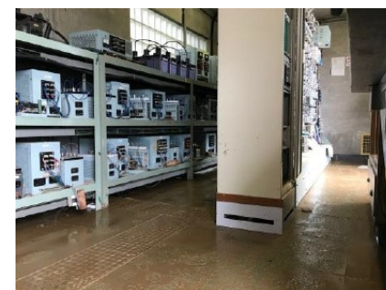
電気設備の冠水
