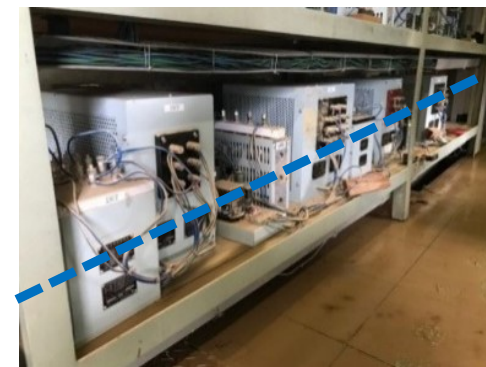
【電気設備の冠水事例】
