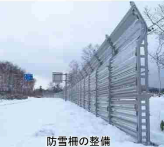
防雪柵の整備
