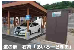
【道の駅でのEV充電状況】
