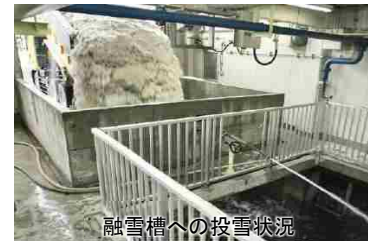
融雪槽への投雪状況
