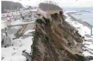
【国道335号海岸浸食の状況】
