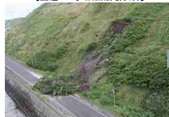
【国道232号 法面崩壊状況】
