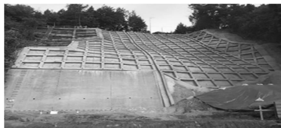
コンクリート枠による斜面の補強
