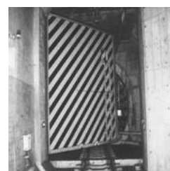
防水扉(トンネル内)
