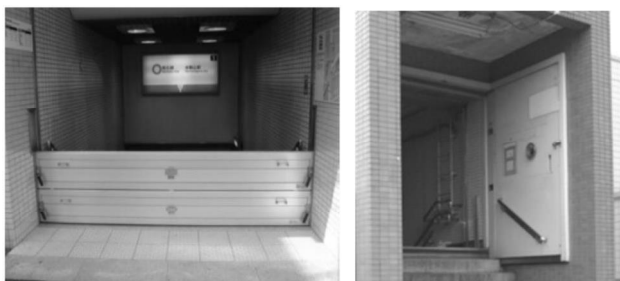
止水板・防水扉の整備
