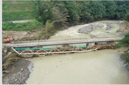
<被災して崩落した水道管>
