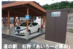
【道の駅でのEV充電状況】
