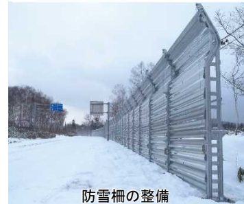
防雪柵の整備
