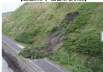
【国道232号 法面崩壊状況】
