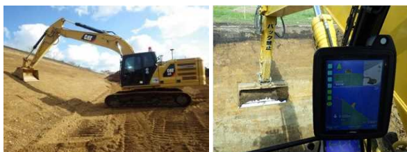
道路の新設工事におけるICT建設機械での切土法面の掘削状況
