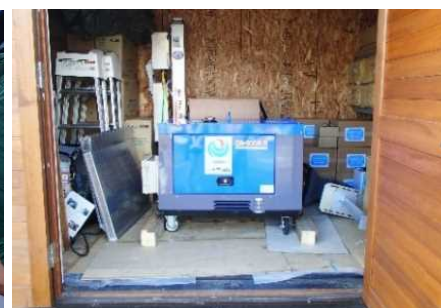
非常用発電設備の設置
