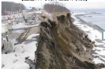
【国道335号海岸浸食の状況】
