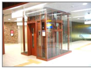
エレベーター
