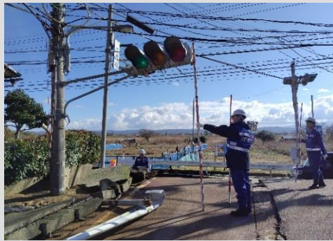
道路の被災状況調査 (石川県内灘町)
