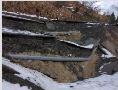
＜被災して露出した水道管＞
