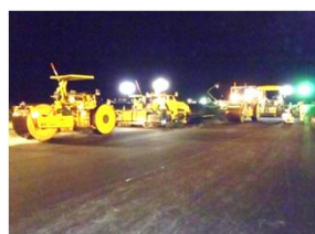
(老朽化した滑走路舗装の改良)
