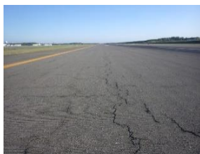
(舗装のひび割れが発生)
