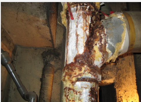
排水管の腐食により漏水が発生し、配管改修が必要
