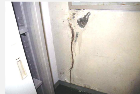
外壁クラックから漏水が発生し、外壁・内部改修が必要
