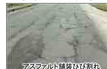
アスファルト舗装ひび割れ
