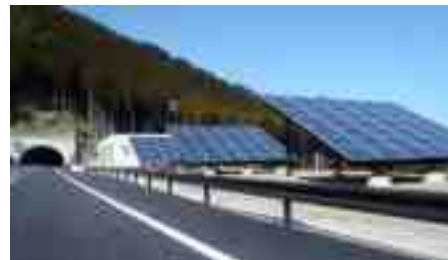
道路空間の太陽光発電設備
