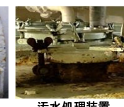
汚水処理装置タンクの腐食
