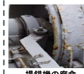
揚錨機の腐食・電装品の劣化
