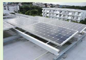
太陽光発電関連設備の設置
