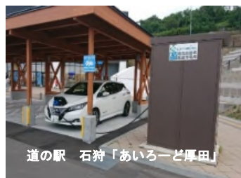
【道の駅でのEV充電状況】
