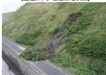
【国道232号 法面崩壊状況】
