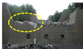
水通しの損傷(砂防えん堤)
