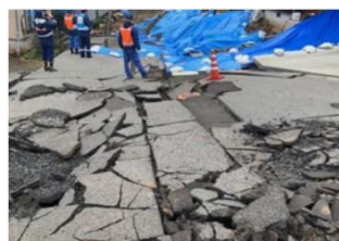
令和6年能登半島地震による水道管の被災状況(R6.1)
