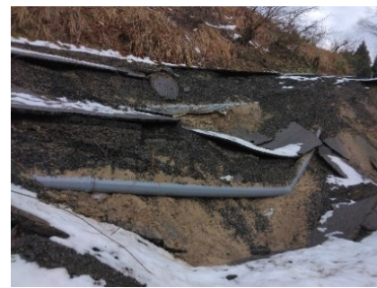
浄水場から配水池へ向かう水道管 の破損・露出（石川県輪島市）
