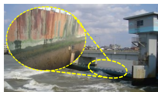
ゲート設備劣化(堰)
