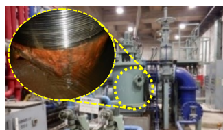
フィルター内部劣化(排水機場)
