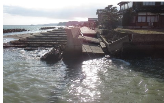
宝立正院海岸における護岸損傷 (石川県珠洲市)
