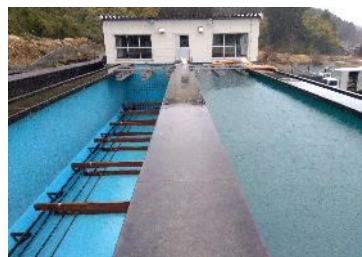
浄水場の被害(珠州市宝立浄水場)
