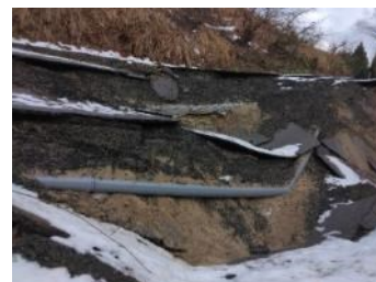
送水管の被害(輪島市)
