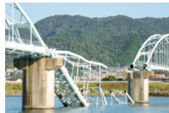
和歌山市水管橋の落橋による断水(R3.10)
