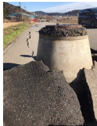
下水道マンホールの浮き上がり (石川県輪島市)
